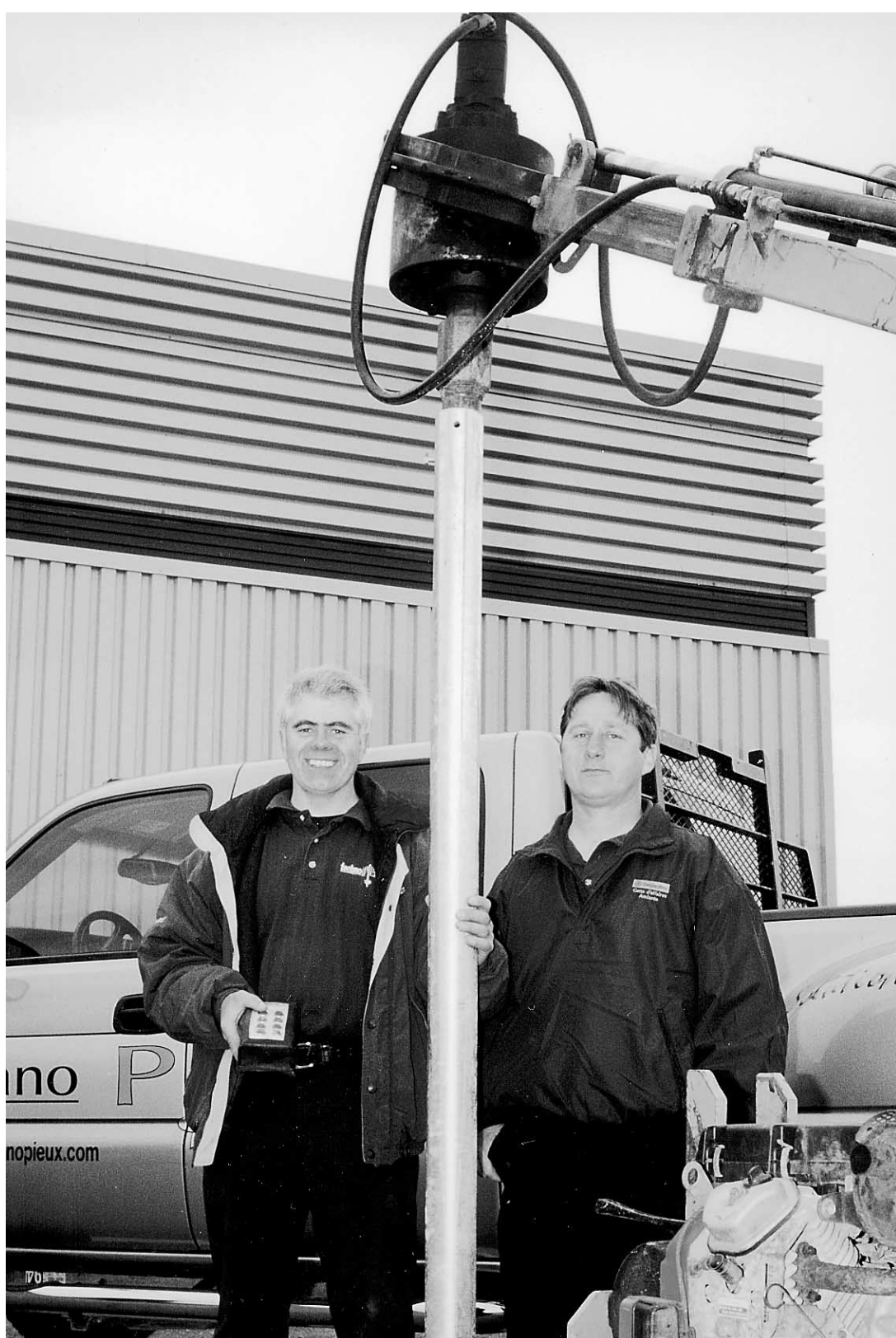
Le concept de pieux vrillés a été mis au point par Daniel Thivierge et Clément Binet.
